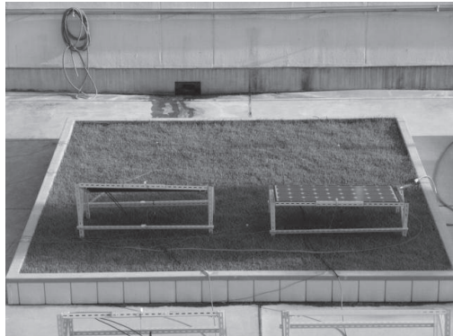
写真1 緑化面に設置したソーラーパネル
