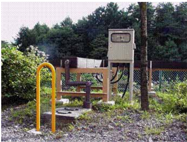
揚水井戸13箇所 (2重構造による漏洩防止)
