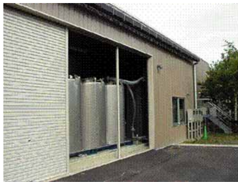
地下水浄化設備
